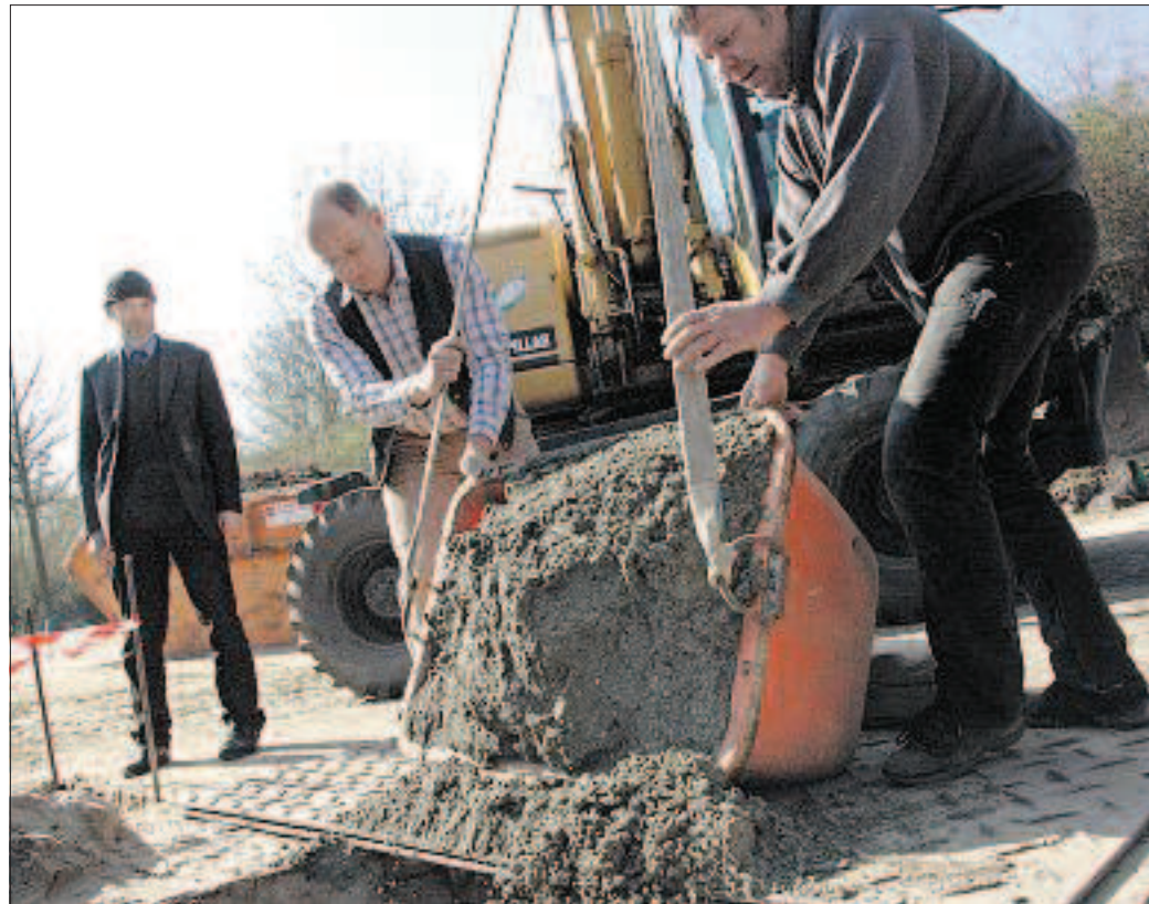
Uwe Spiekermann (links) und Uwe Stahl bereiten das Fundament für den erzählenden Stein vor, den sie nächste Woche am Nordeingang errichten werden. Dorndorf (2)
